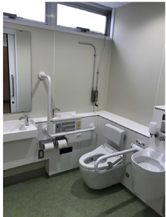
オストメイトが設置されたトイレ
