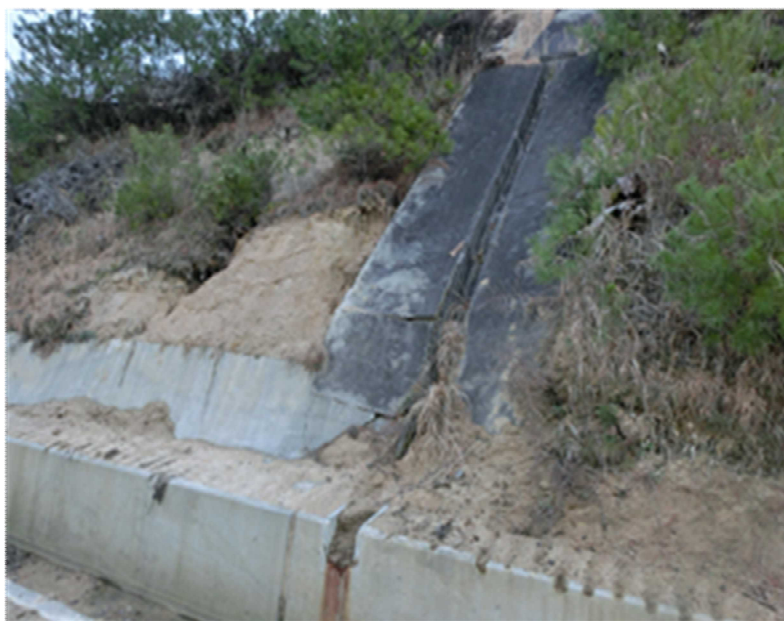
(災害で発生した土砂により崩壊した法面と破損した縦型側溝)
