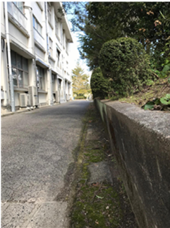
(樹木の根に押され、逆勾配となった擁壁)
