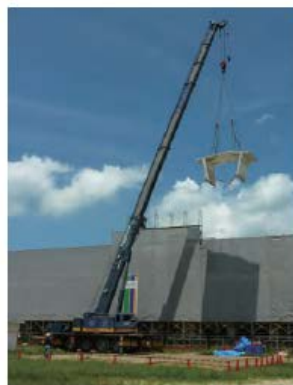
コンクリートカッターによるスラブ切断状況。3階部分を切断して2階建てに。工事は仮校舎を建てることなく、下階を使用しながら行った。
