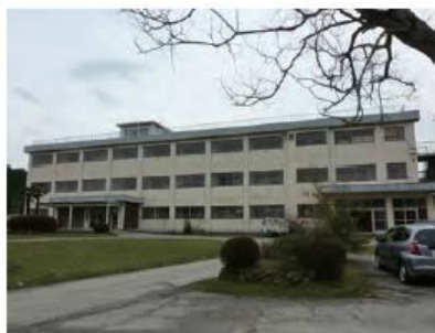
本館改修前。築46年の鉄筋コンクリート3階建てだったが耐震基準を下回っていることが判明。50周年事業として再生整備を行うことになった。
