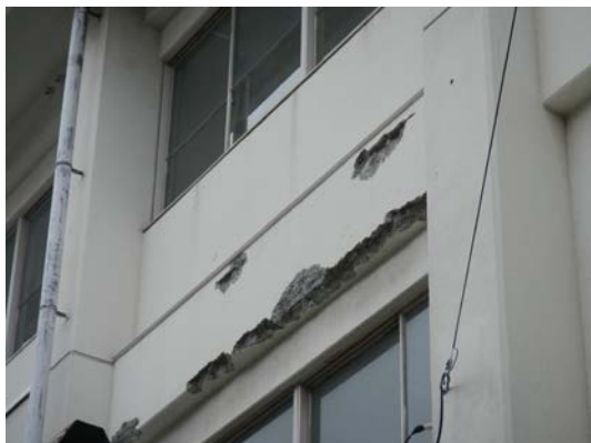
コンクリートの爆裂
