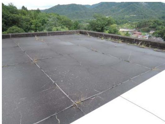
防水性を失った屋根
