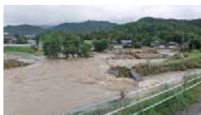
県道の陥没箇所(新宮地区)
