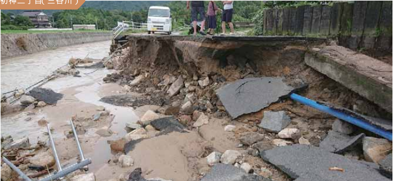
護岸が崩壊し、道路まで抉り取っています。水の勢いが凄まじかったことがよく分かります。
