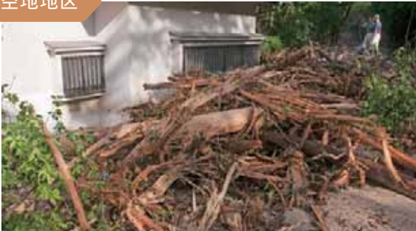
撮影：2018年7月9日 》 流木が外壁を壊し堆積。
