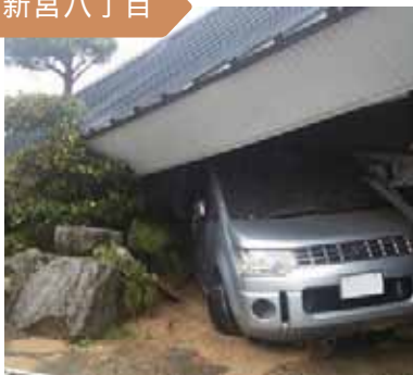
屋根につぶされた愛車。
