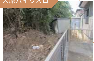
撮影：2018年7月27日 入口の倉庫、側溝塞ぐ。町へ調整&除去依頼。
