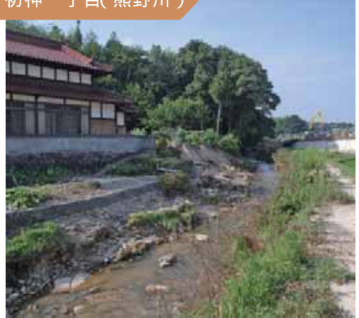
川の護岸が崩れています。この付近は非常に広い範囲で川の護岸が崩れる被害が発生しました。
