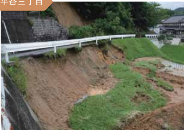
崩れた土砂が耕作中の田んぼに流れ込みました。このように農地被害は、町内53箇所を確認されました。
