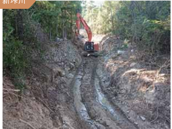
普段は、水の流れの少ない川からも、土石が流れ出し、川を埋め尽くしました。
