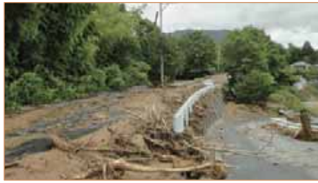
城之堀八丁目 撮影：2018年7月7日 農道熊野北線土砂流入。
