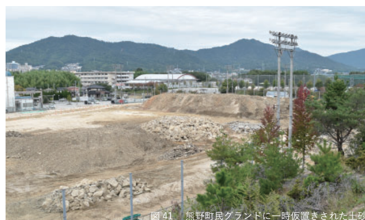
図41 熊野町民グラウンドに一時置きされた土砂
